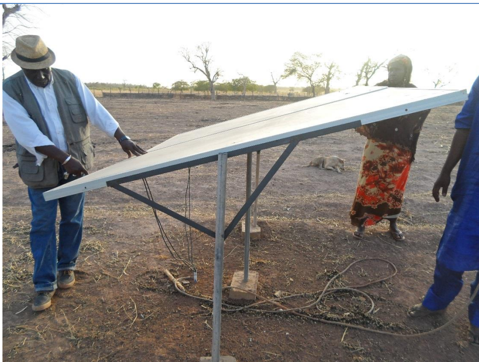
Photo 9: panneau solaire pour la pompe
