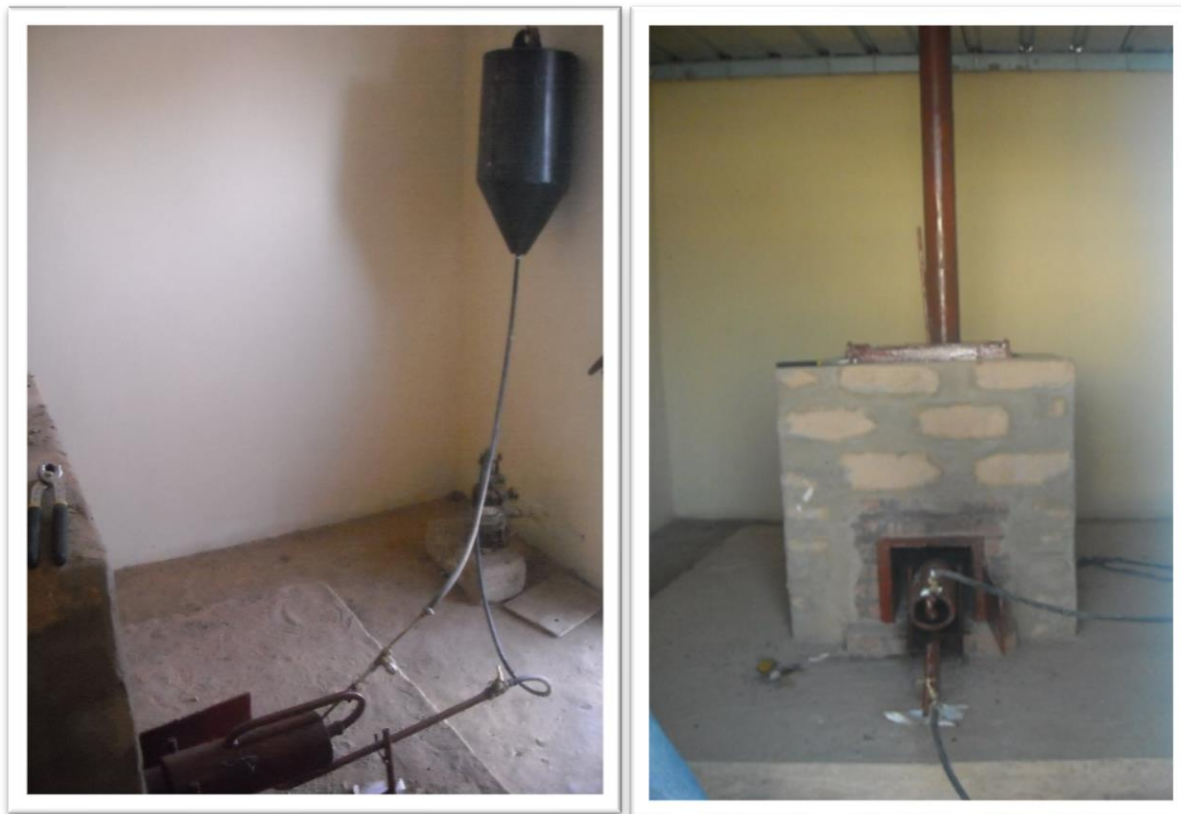
Image 2: Incinérateur artisanal de type Montfort, poste de santé de Mery
