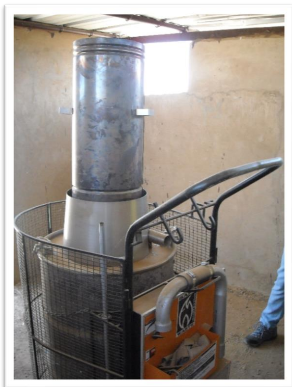
Image 3: Incinérateur électromécanique, Centre de santé de Galoya
