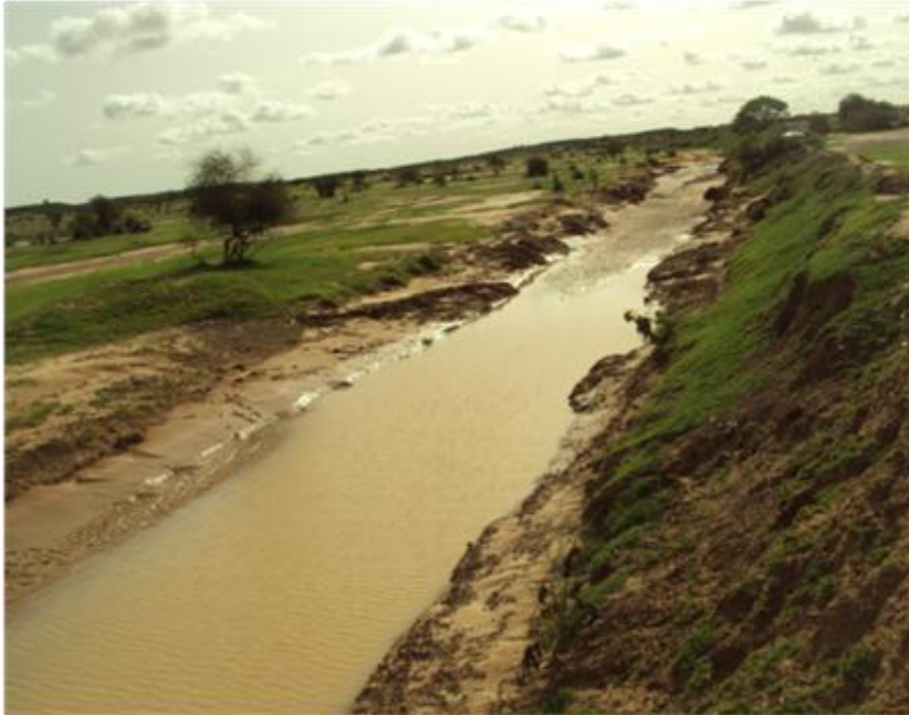
Digue d'Ourossogui pré-existante (à réhabiliter), lors de la saison des pluies
